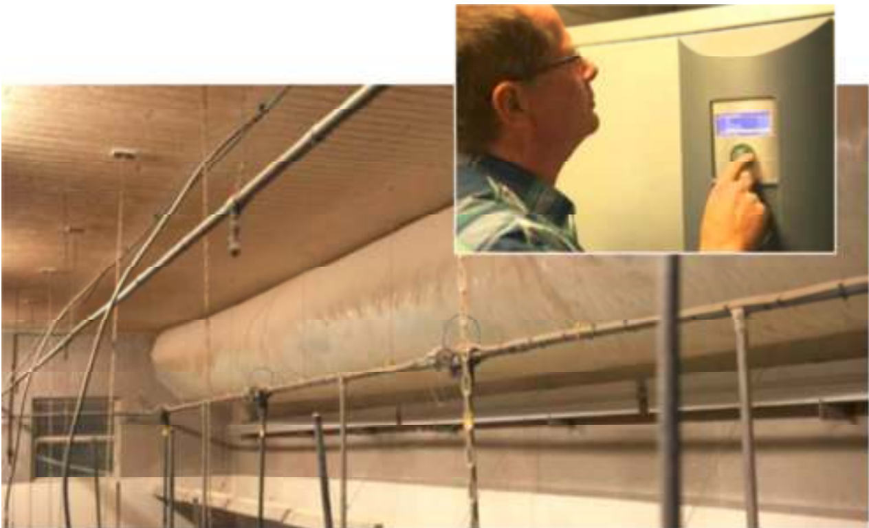
Έλεγχος της θερμοκρασίας στην μονάδα του Timo Heikkila, Φινλανδία
